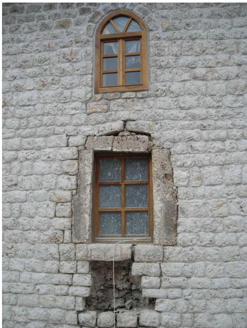
Pukotine na fasadnim zidovima i oštećenja na doprozornici
